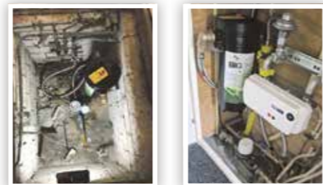
Filter geplaatst in kruipruimte Filter geplaatst in meterkast
