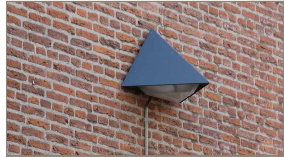
Bestaande verlichtingsarmatuur passend bij de gewenste uitstraling
