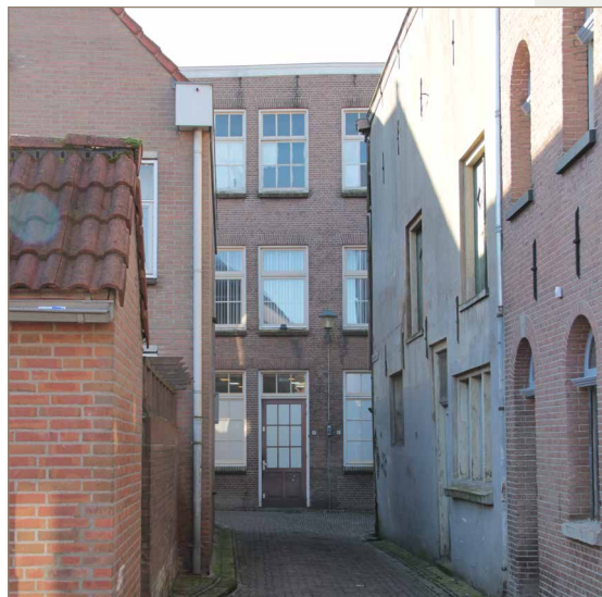
Pakhuis op de kop van de Kabeljauwsteeg, slecht onderhouden
