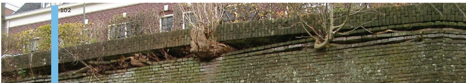
vervormingen bestaande muur Westwal
