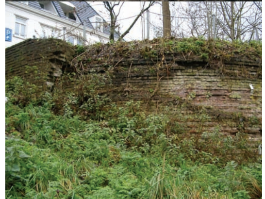
Deplorabele toestand muurwerk
