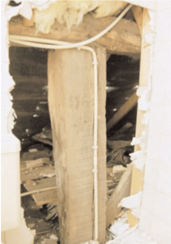
Afb. 14. Stijl met fliering en windverband van het eerste gebint (ook afb. 13) boven de zoldervloer.
