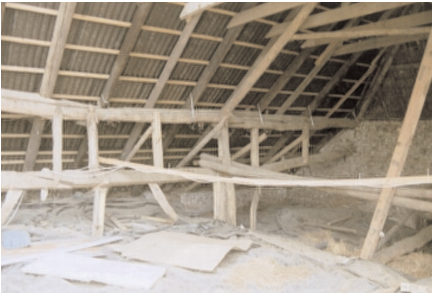
Afb. 20. De zolder van het bedrijfsgedeelte. Boven de vloer steken de stijlen van de twee gebinten uit. Op deze stijlen ligt een fliering, voor een langsstabiliteit zijn windverbanden tegen de stijlen en fliering aangebracht.
