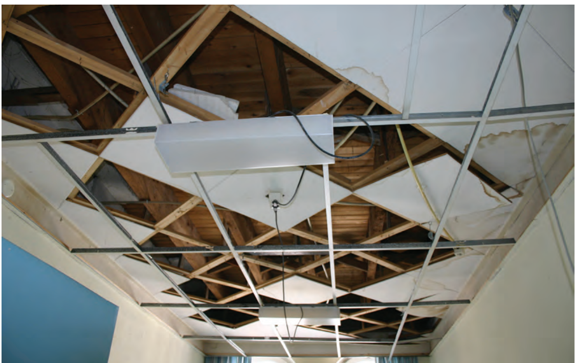
In de vertrekken ten noorden van de gang ontbreken stucplafonds. De bovenliggende enkelvoudige vloerconstructie is op enkele plaatsen in het zicht.
