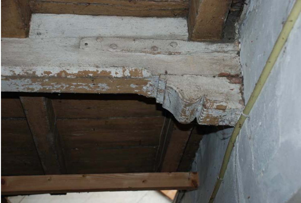
Afbeelding 14. Een detailopname van de samengestelde balklaag met de console met een ojiefprofilering die op basis van stilistische kenmerken in de 17 de eeuw te dateren is.
