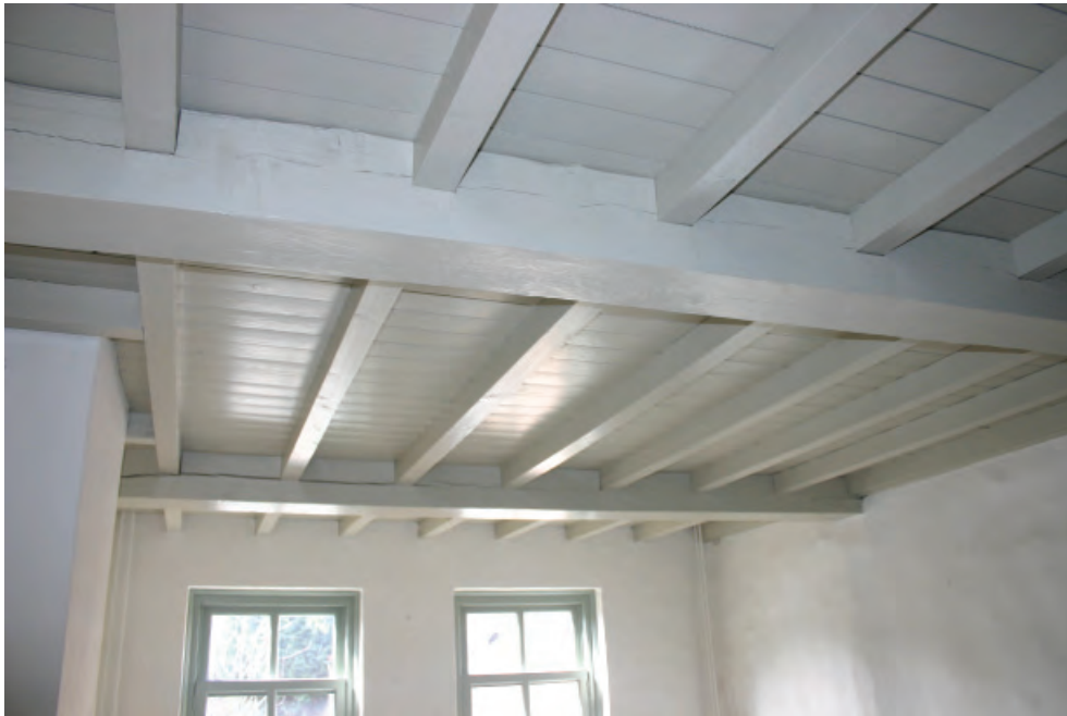
Afb. 9. De tijdens de restauratie aangebrachte samengestelde balklaag van de zoldervloer in het achterhuis.
