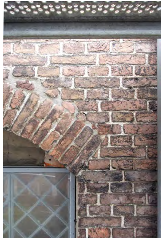
Afbeelding R03: Duidelijk te zien is dat de dagkanten van de huidige vensteropeningen niet oorspronkelijk zijn. Het metselwerk is afgehakt, waarna de dagkanten zijn gecementeerd. Ook de segmentboog is in bestaand metselwerk aangebracht, getuige de opvulling van de ruimte boven de geslagen boog met brokken steen. Ook een verschil in mortel laat zien dat er sprake is van een bouwphase. Op de foto ook een deel van een gietijzeren venster, aangebracht tijdens de verbouwing tot Bank van Leening.
