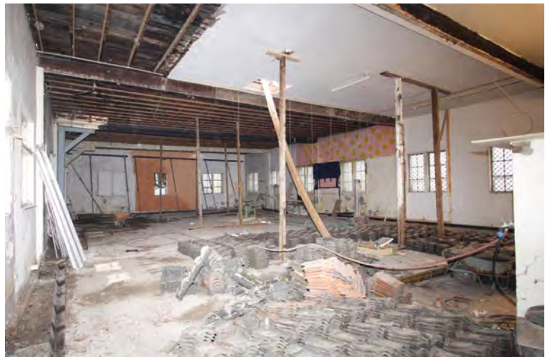
Afbeelding BG01: De begane grond gezien in de richting van de achtergevel, ten tijde van het verwijderen van de dakpannen. Alleen het voorste deel van het pand heeft een stucplafond.
