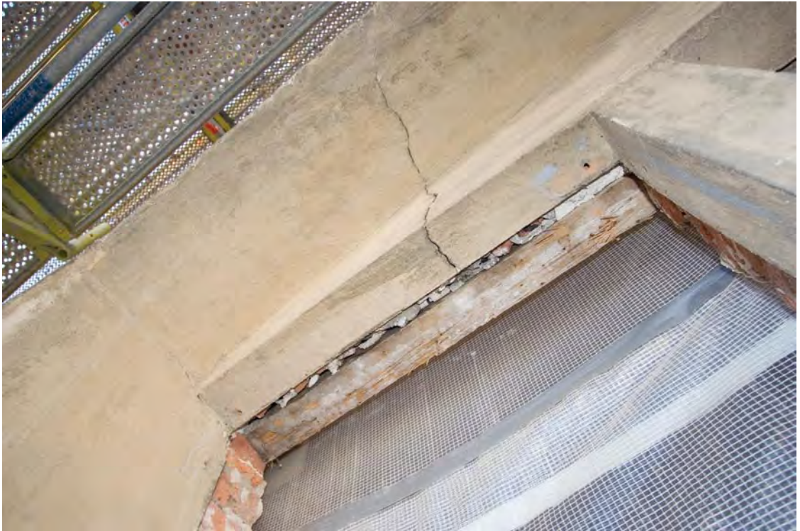
Afbeelding L15: Van buitenaf zijn ter plaatse van de huidige vensteropeningen ook delen van het eikenhouten ringanker te zien.
