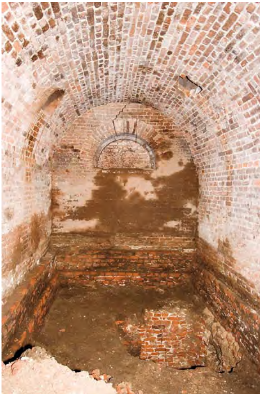
Afbeelding S02: De eerste ruimte links van de gang. Duidelijk zichtbaar de versnijdingen van de fundamente en de dichtgezette opening van een verdwenen rondboogvenster. In doorsnede de aangetroffen funderingsstrook.
