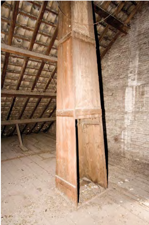
Afbeelding z05: Een vermoedelijk nog negentiende-eeuws rookkanaal direct achter de voorgevel. Stookplaatsen en rookkanalen zijn niet weergegeven op de bouwtekeningen uit 1930.
