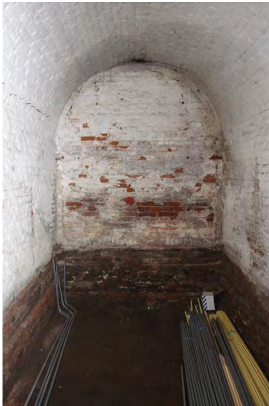
Afbeelding S10: Oorspronkelijk een brede toegang tot het souterrain, vanaf het binnenterrein van de glasfabriek (zie de rollaag net boven het donkere metselwerk dat tevens het oorspronkelijke vloerniveau markeert), in 1854 dichtgezet.
