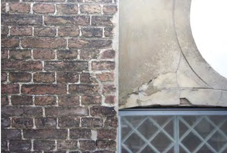
Afbeelding R05: De vensteropening met het ronde raam is oorspronkelijk een venster zoals de overige in de zijgevel. Het venster is naar boven toe vergroot waarbij het ronde raam is toegevoegd. Een bewijs hiervoor is de aftekening van een verdwenen segmentboog.
