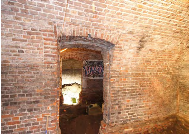
Afbeelding S08: Ook hier is te zien dat de ontlastingsbogen van de deuropeningen zijn gemetseld voordat de gewelven werden aangebracht.
