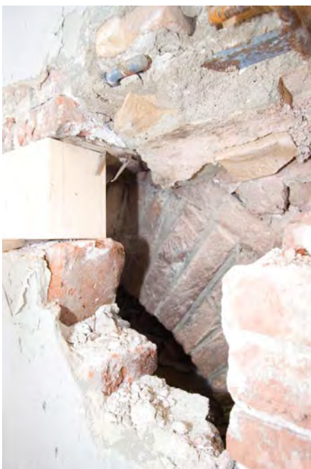
Afbeelding L11: In detail het deel van de oorspronkelijke vensteropening, met een recente klos daar waar het eikenhouten ringanker gedeeltelijk is verdwenen. Net naast de klos bevindt zich een gevelanker. Dit gevelanker heeft in het exterieur een rozet. Met het anker werd de segmentboog boven de vensteropening verankerd aan het in het metselwerk opgenomen ringanker. Op de foto is goed te zien dat de boog boven de dichtgezette vensteropening niet dezelfde breedte heeft als de gevel.
