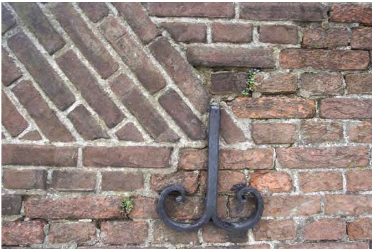
Afbeelding V05: Een detail van een van de vlechtin- gen, die duidelijk niet oorspronkelijk zijn. De vlechtin- gen zijn op basis van tekeningen in het bouw- dossier te dateren in 1931.
