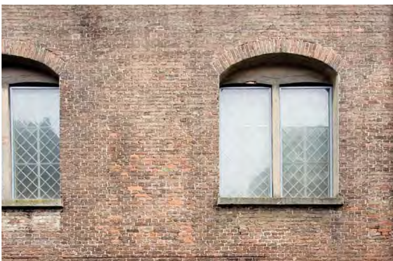
Afbeelding R01: Detail van de rechter zijgevel. Tussen de vensteropeningen tekent zich een dichtgezette vensteropening af. Het metselwerk wijkt iets af, vooral in kleur. De ontlastingsconstructie van de oude vensteropening is verdwenen. Onder het venster rechts tekent zich een deel van een soortgelijke dichtzetting af. Dit venster is aangebracht op de plaats van een smallere opening.
