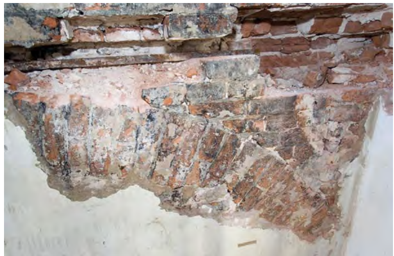
Afbeelding L08: Het rechterdeel van de boog die aansluit op de achtergevel. Boven de boog is een verankering zichtbaar. De bakstenen zijn beroet, hetgeen op een brand zou kunnen wijzen.
