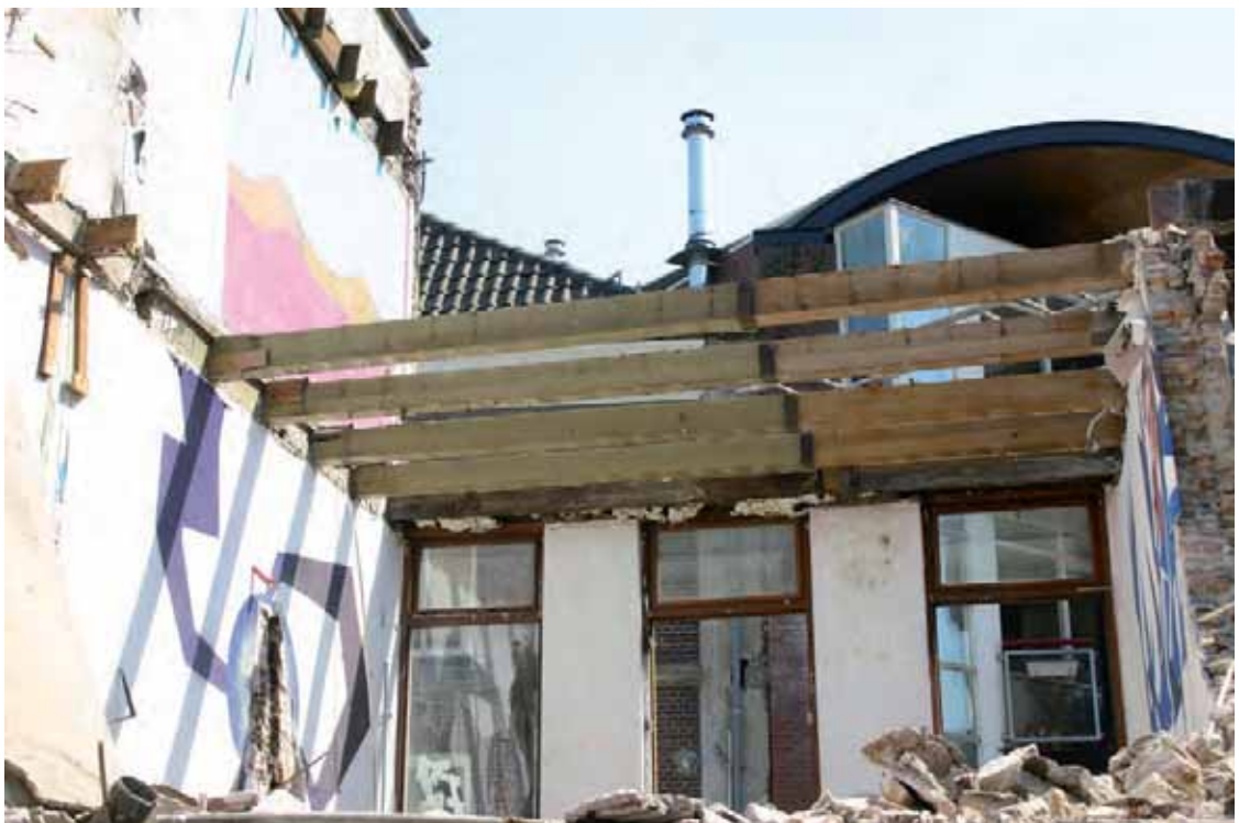
Afb. 19 Zicht op de enkelvoudige balklaag van de eerste verdiepingvloer van het pand Stoofstraat 3 in de richting van de voorgevel.
