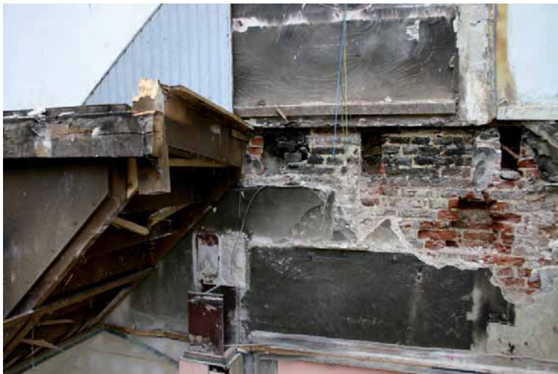
Afb. 40 Een detail van de linker zijmuur op het niveau van de eerste verdiepingvloer ter plaatse van de aansluiting van de steektrap met duidelijk de balkkopgaten in het beroete muurwerk en een restant van de staalconstructie op de begane grond.
