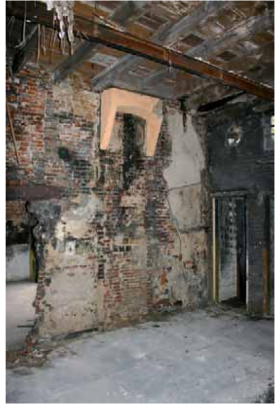
Afb. 50 Het achterste deel van de linker zijmuur, met op de foto de doorgang naar het buurpand Stoofstraat 11-13. Boven de latei tekent zich een bouwnaad af. Het muurwerk links van deze naad is op een zorgvuldige manier uitgevoerd, met gebruikmaking van zogenaamde kop-klezoor oplossingen, hetgeen gebruikelijk was tot in de late zestiende- en vroege zeventiende eeuw.
