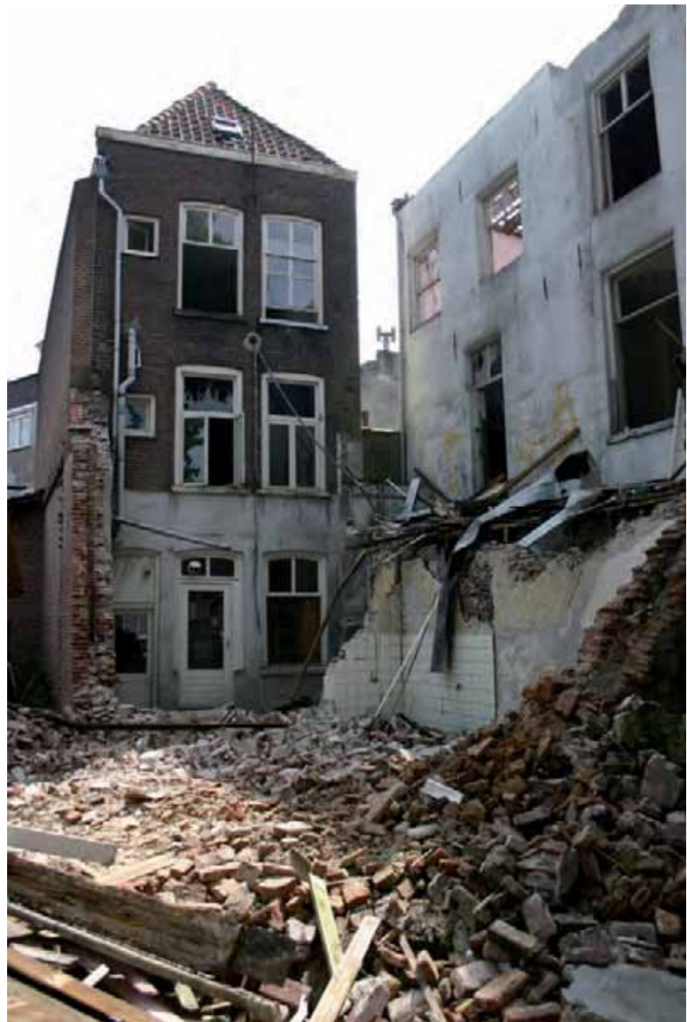
Afb. 71 Een overzichtsfoto na de sloop van het achterhuisje met zicht op de achtergevel van het pand aan de Snellestraat. Rechts op de foto de achtergevels van de panden Stoofstraat 3 en Stoofstraat 5 tijdens de sloop.
