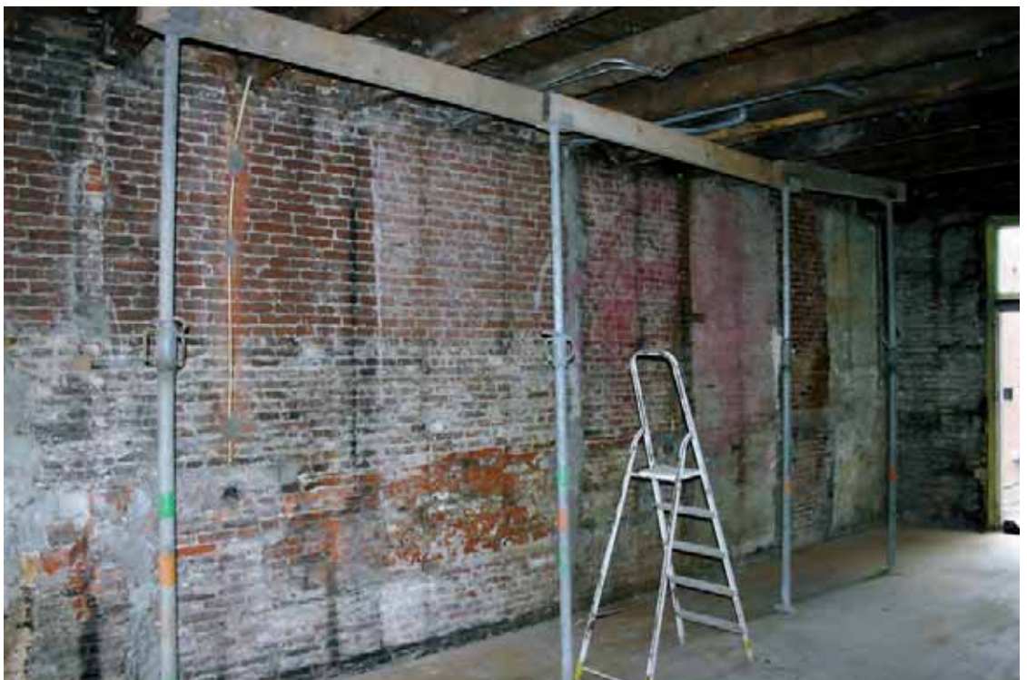
Afb. 58 Zicht op de linker zijmuur van het pand op de eerst verdieping, gezien richting de achtergevel. Op circa 1,20 meter boven de vloer tekent zich een bouwnaad af die erop duidt dat het pand is opgehoogd.
