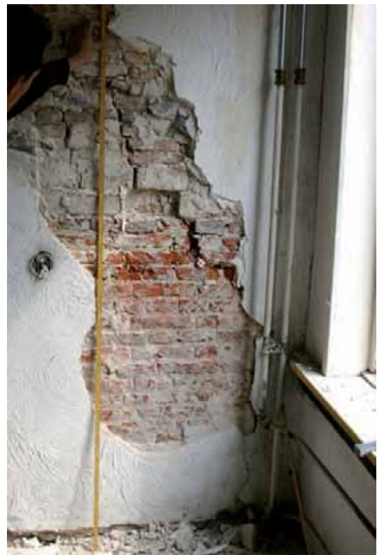
Afb. 35 Een foto van de rechter zijmuur op het niveau van de verdiepingsvloer van het pand Stoofstraat 5. Op de foto is een horizontale bouwnaad zichtbaar. Het onderste deel van het muurwerk bestaat uit zestiende-eeuwse bakstenen, voorzien van een afwerking die er op wijst dat dit muurwerk oorspronkelijk buitenwerk moet zijn geweest.
