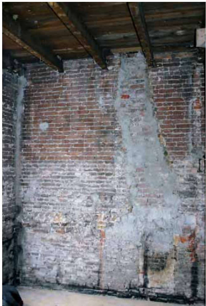
Afb. 59 Zicht op de linker zijmuur van het pand op de eerste verdieping, gezien richting de voorgevel. Op circa 1,20 meter boven de vloer tekent zich een bouwnaad af die erop duidt dat het pand is opgehoogd, rechts op de foto de afdruk van een verdwenen schouw met rookkanaal.
