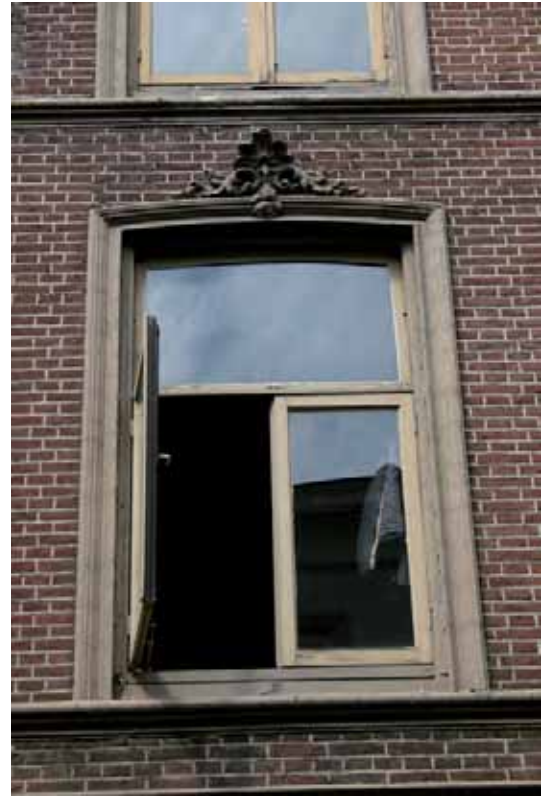
Afb. 44 Een detail van een van de in de jaren vijftig van de afgelopen eeuw vernieuwde vensters in de voorgevel van het pand Stoofstraat 7-9.
