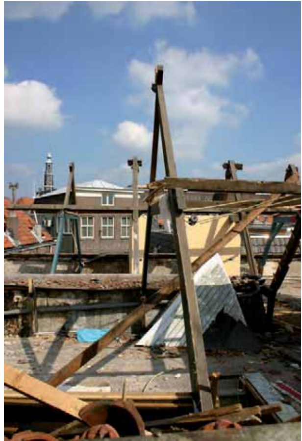
Afb. 23 De kappen van Stoofstraat 3 (achtergrond) en Stoofstraat 5 tijdens de sloop. Links op de achtergrond het enige negentiende-eeuwse kaspant van de kap van Stoofstraat 3 dat grote overeenkomsten vertoont met het negentiende-eeuwse kaspant op de voorgrond.
