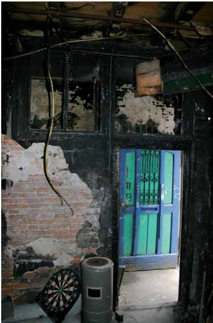
Afb. 63 Van het interieur rest enkel de trap met ombouw. De pui op de foto gaf toegang tot de bedrijfsruimte op de begane grond. De zwartgeblakerde toestand van de pui laat zien dat er in het pand brand heeft gewoed.
