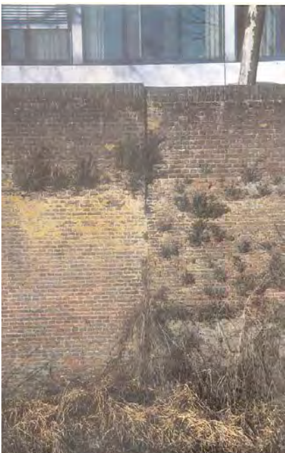
De stadsmuur is in de loop der tijden verschillende malen hersteld. Op verschillende plekken zijn naden zichtbaar die restauraties en reparaties markeren. Niet alleen het weer heeft een negatieve invloed op de toestand van de ommuring, ook de vegetatie tast het muurwerk aan (foto BAAC bv).
